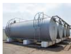
· IBC et réservoir de fluide
